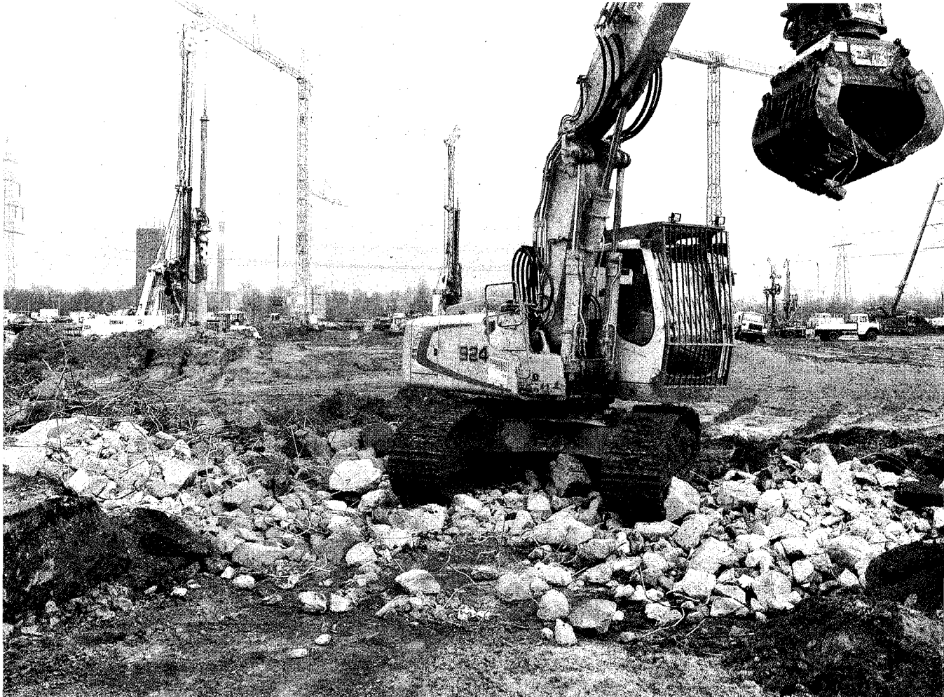
Eine der größten Baustellen der Region: Für 1,4 Milliarden Euro entsteht im Stummhafen das Trianel-Steinkohlekraftwerk. Schon während der Bauphase fließt Abwasser ins städtische Kanalnetz. Das dämpft den Gebührenanstieg. RN-Foto Goldstein
